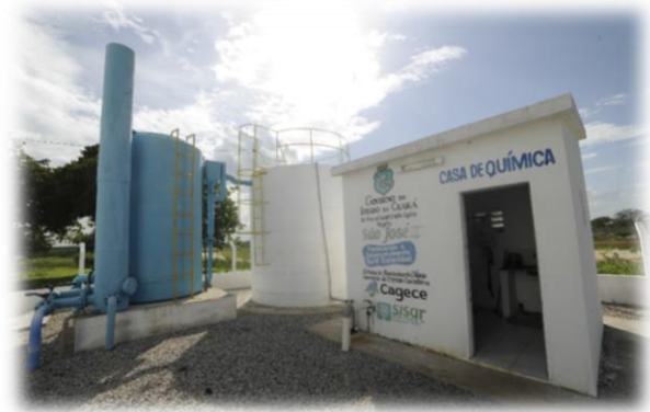
Figura 19 - Sistema de tratamento de água em Cascavel (CE). Em destaque filtros diretos ascendentes e casa de química. Fonte: Alves (2016).
