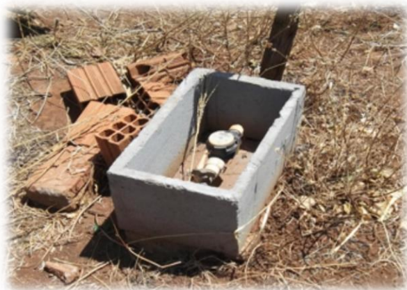
Figura 20 - Hidrômetro domiciliar com caixa de proteção. Fonte: Rocha (2013).
