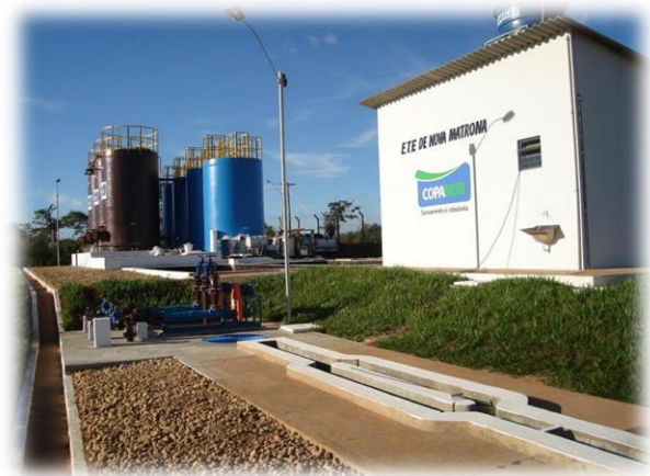
Figura 17 - Estação de tratamento de esgoto de Nova Matrona (MG). Fonte: Moreira Júnior (2012).
